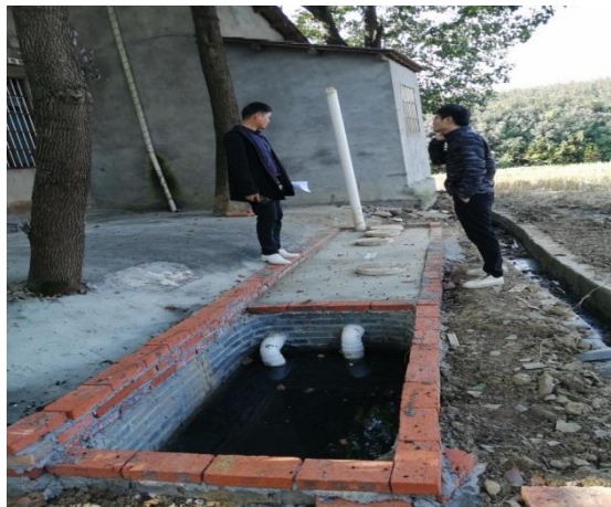
图 2-5 沙岭村玻璃钢化粪池
